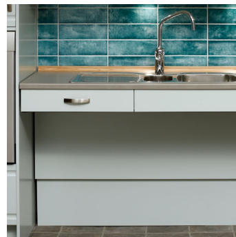
Die Installationsverkleidung verbirgt die Technik.
